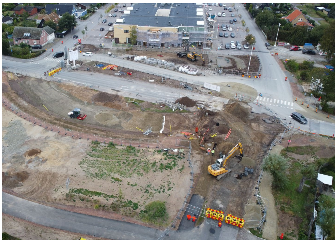
En hög tillväxt i kommunen ställer krav på fortsatt utbyggnad. Här växer Bjärreds torg fram.
